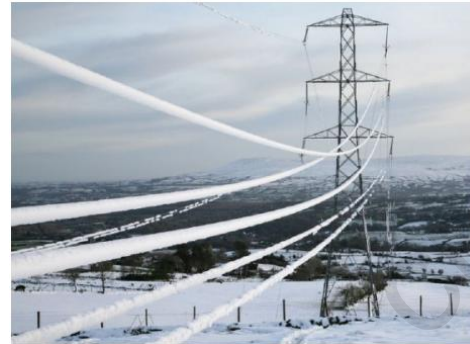
高压线缆，缆车，供电线缆（火车和电车） 型等
